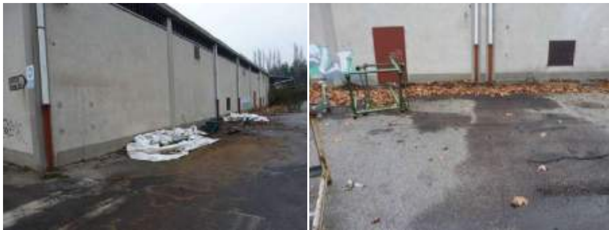
Macchie di idrocarburi: lato Sud capannone magazzino
