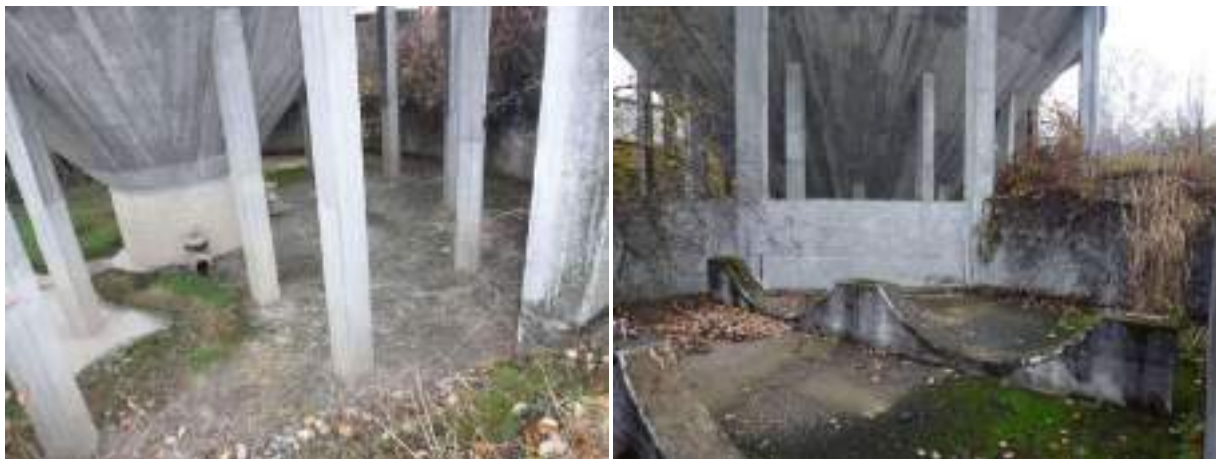
Viste dalla vasca di decantazione
