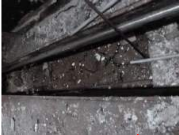
Fossa con idrocarburi
