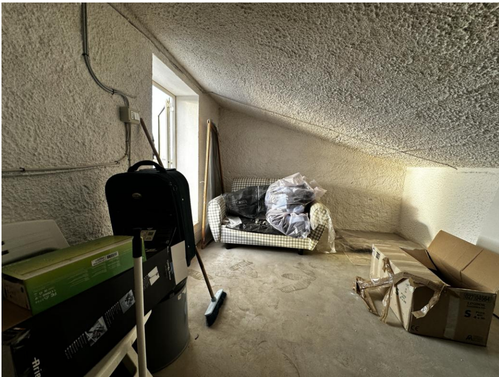
Foto 8 (particolare accessi e aperture abusive sottoetto piano terrazzo)
