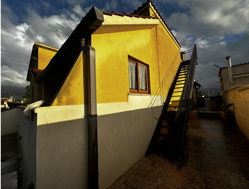
Foto 3 (particolare scala abusiva di accesso al terrazzo)
