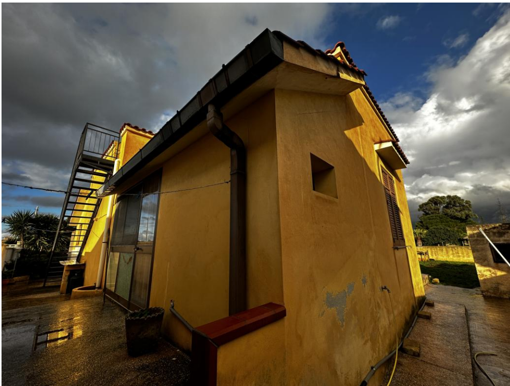
Foto 4 (particolare chiusura veranda con vetrata abusiva)
