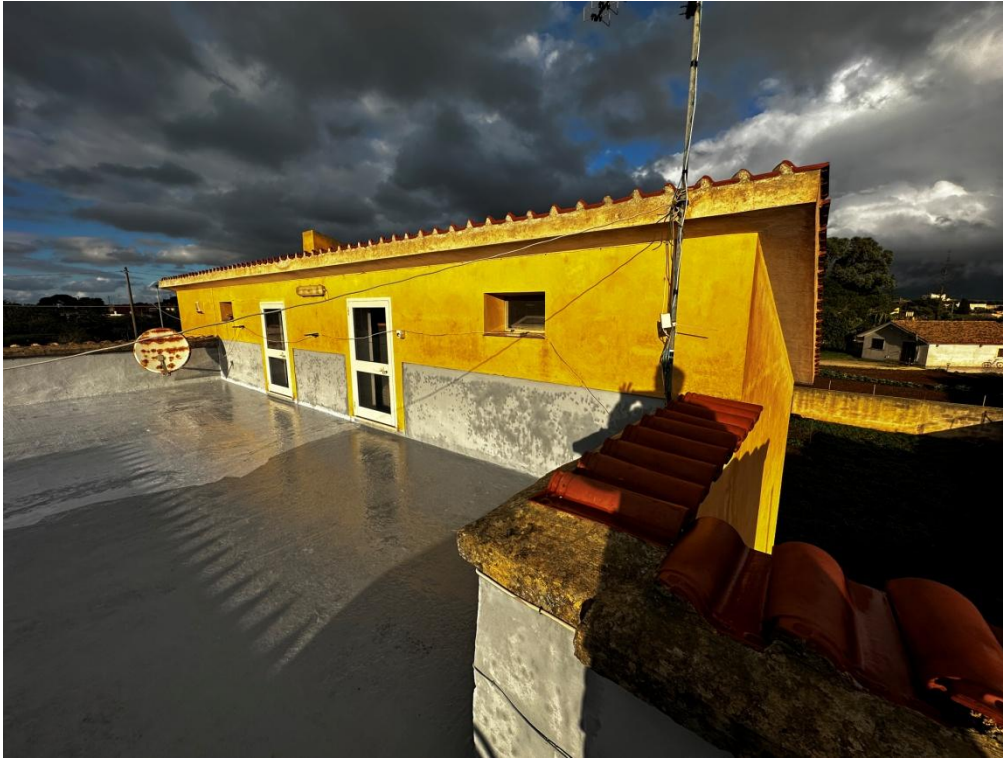
Foto 7 (particolare accessi e aperture abusive sottoetto piano terrazzo)
