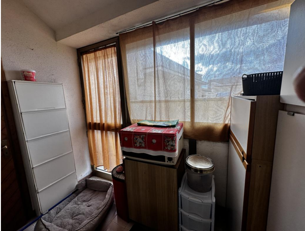
Foto 13 particolare chiusura veranda con vetrata abusiva
