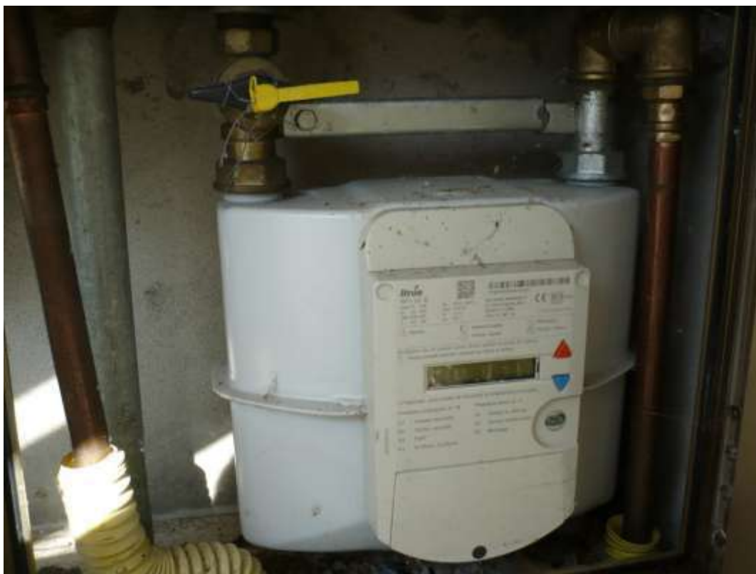
Contatore fornitura gas al servizio dell'appartamento civico n. 13
