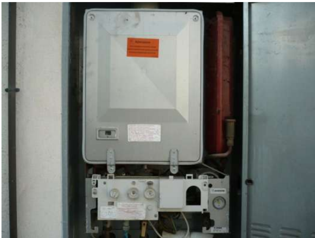
Caldaia esterna del gas al servizio dell'appartamento civico n. 13
