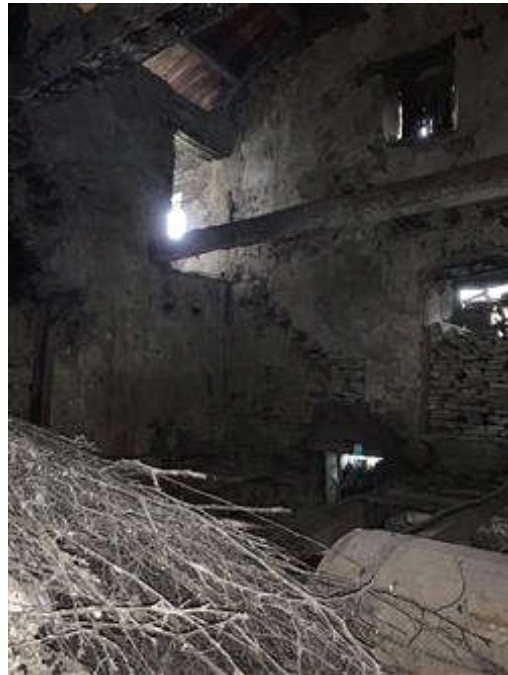
interno solai crollati
