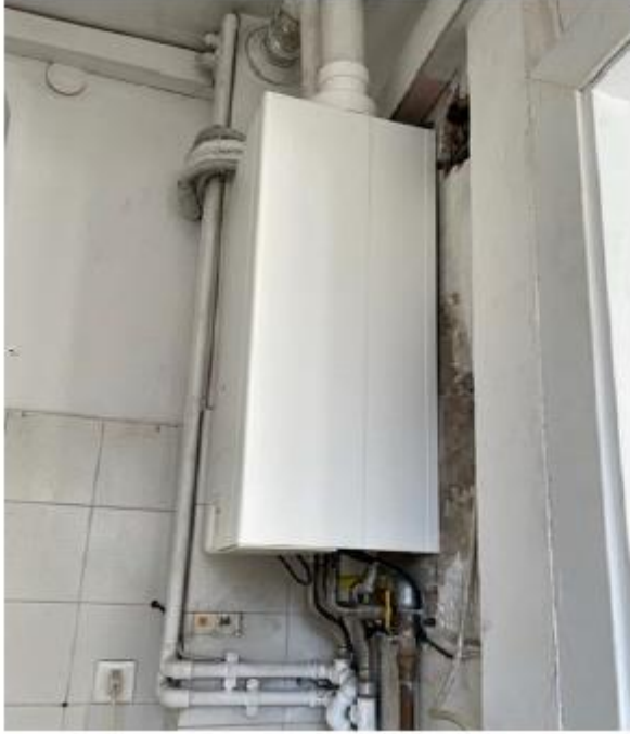
vista della caldaia
