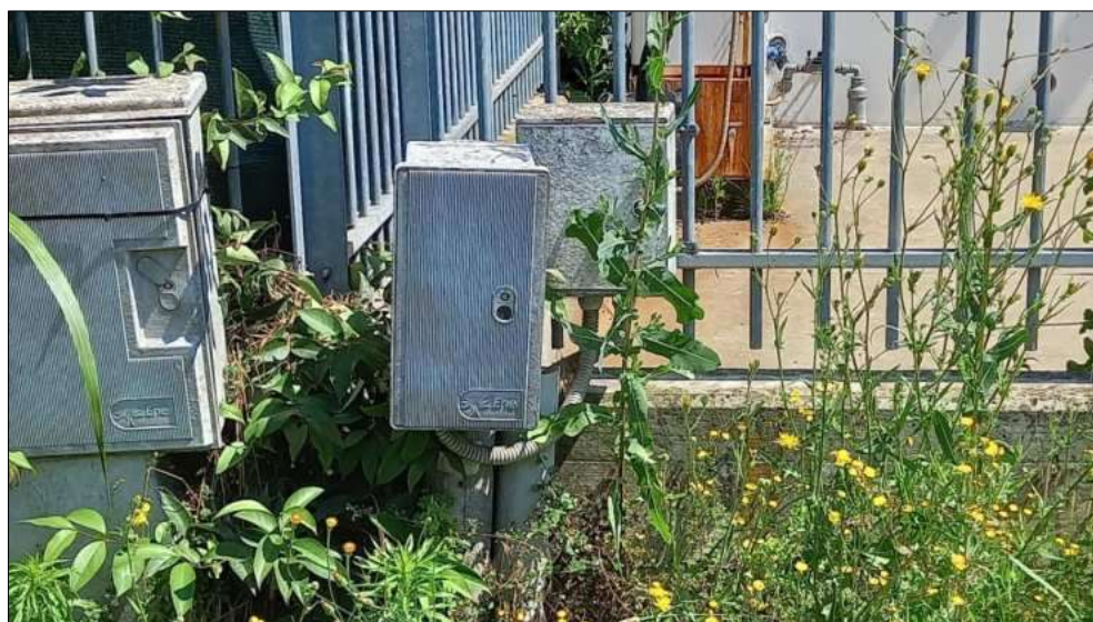
Foto n. 32 – Particolare allacci reti infrastrutturali pubbliche
