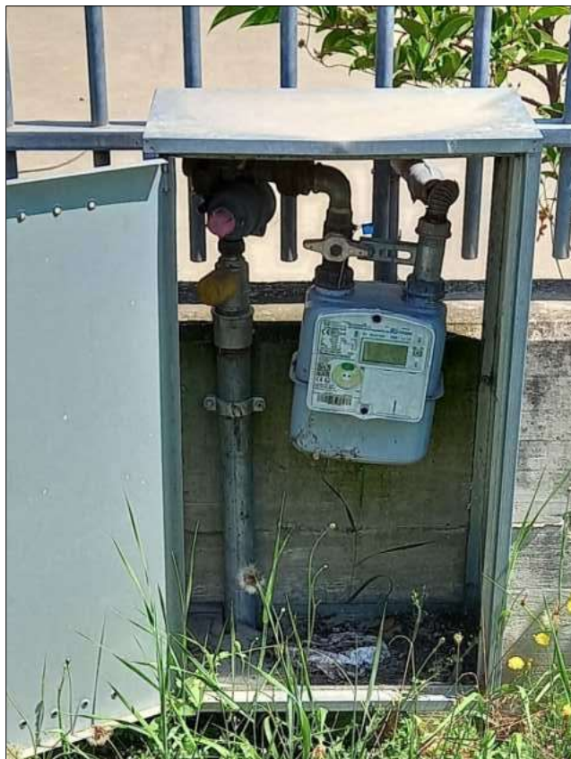
Foto n. 31 – Particolare allacci reti infrastrutturali pubbliche
