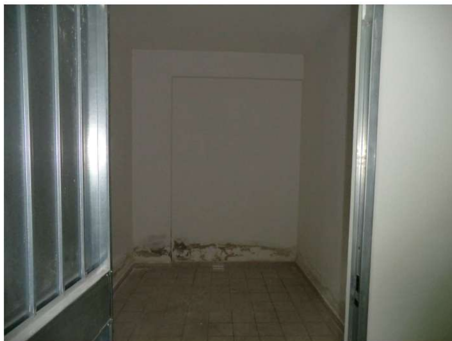
Foto n.10.Via Antonio Stradivari n.1. Cantina sub.36. Sono visibili tracce di umidità di risalita.
