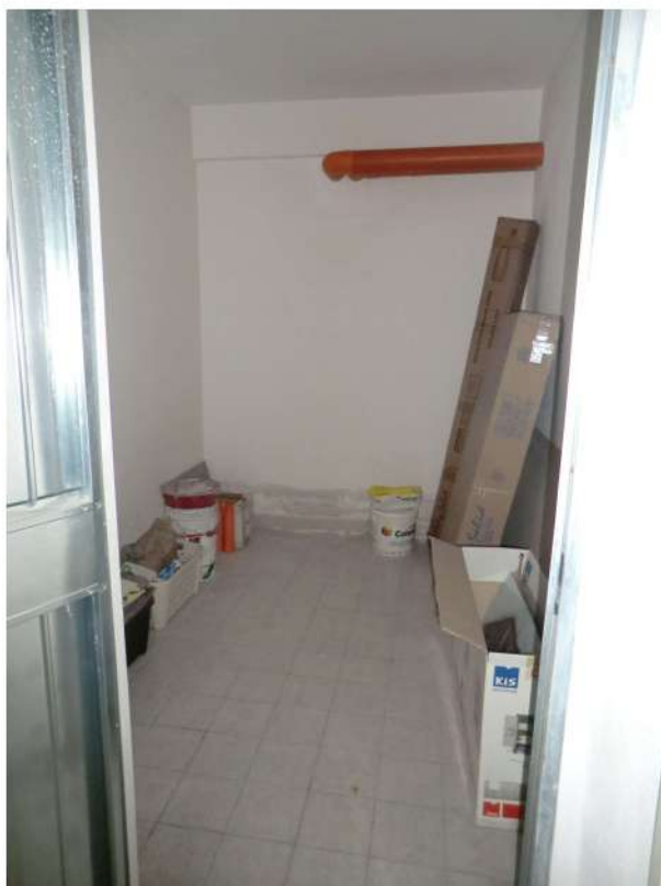
Foto n.11. Via Antonio Stradivari n.1. Cantina sub.35. Sono visibili tracce di umidità di risalita e materiali vari depositati all'interno della cantina.
