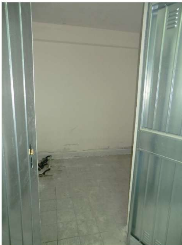
Foto n.18.Via Is Arenas n.14. Cantina sub.24. Sono visibili tracce di umidità di risalita.
