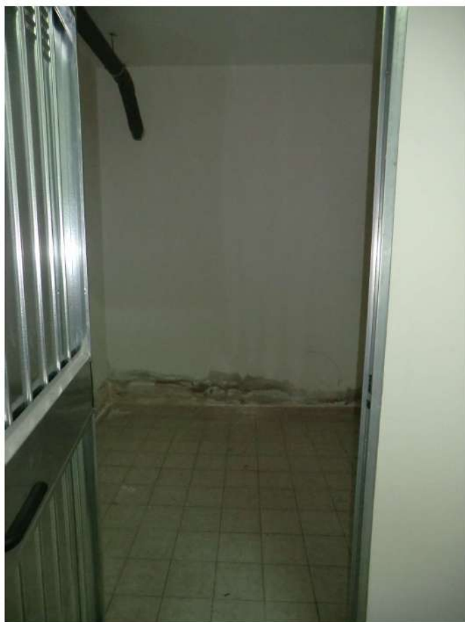
Foto n.9.Via Antonio Stradivari n.1. Cantina sub.37. Sono visibili le tracce di umidità di risalita.
