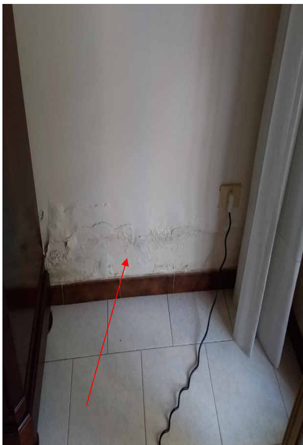
Foto n. 19 - Umidità sulla parete nel soggiorno
