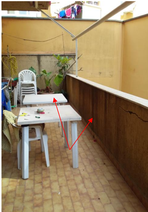
Foto n. 16 - Terrazzo. Lesioni sul parapetto.
