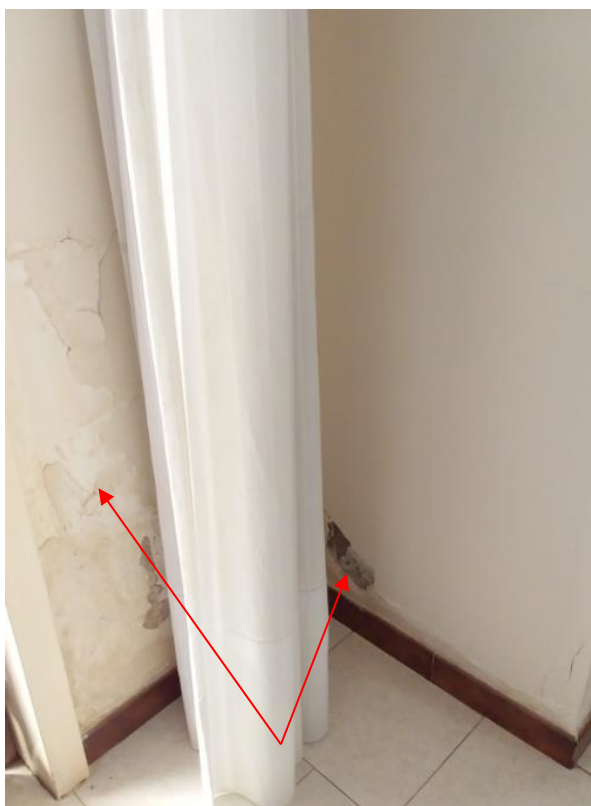
Foto n. 17 - Umidità di risalita nel soggiorno.
