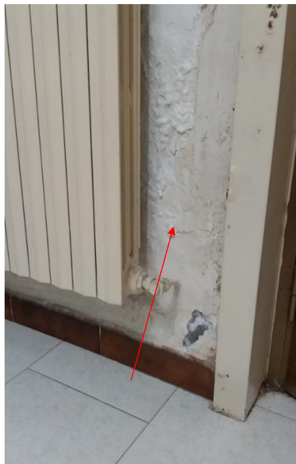
Foto n. 20 - Efflorescenze e formazioni saline
