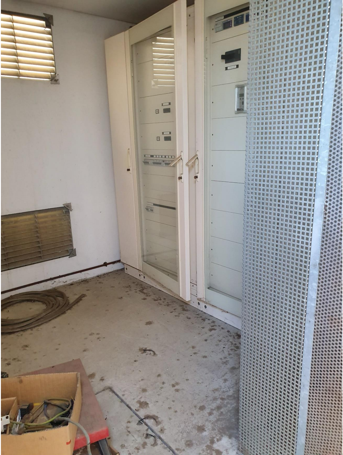
Foto 3 – interno locale elettrico
