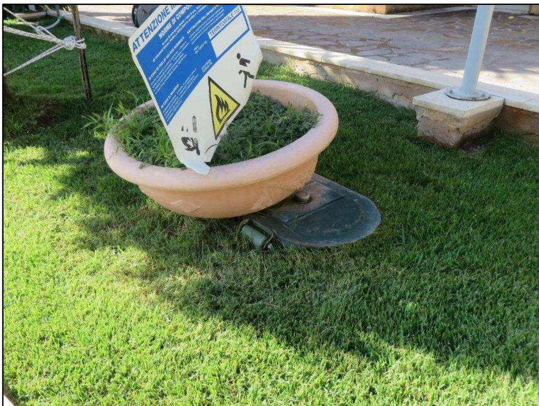
Botola di accesso al serbatoio GPL
