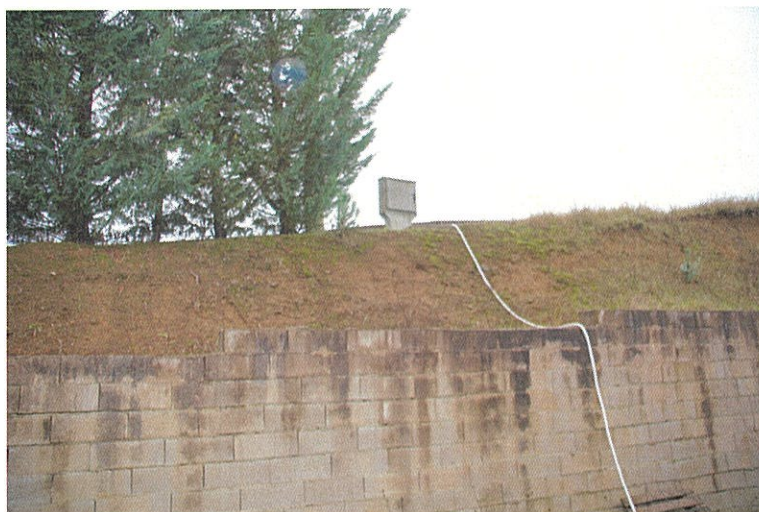
Foto n°19: particolare dell'allaccio alla colonnina della luce.
