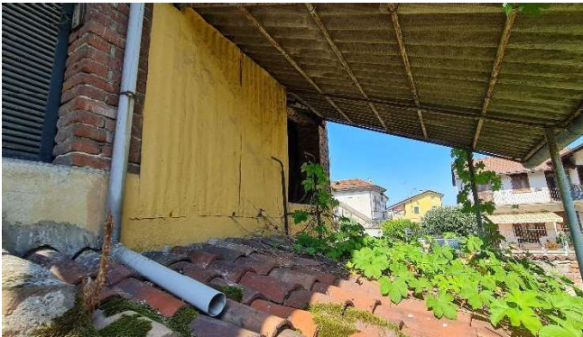
11. Tettoia in difformità
