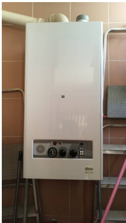
Figura 20 – Caldaia Simplex a servizio dell'immobile
