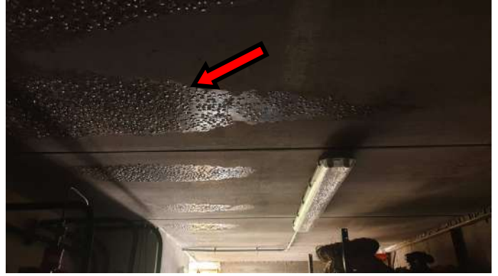
LOCALE DEPOSITO - gocciolamento
