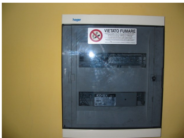
Pannello impianto elettrico
