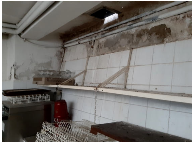
Foto n. 38 – Part. 528 sub 1, 530 e 612 sub 1, graffate - Area dispensa
