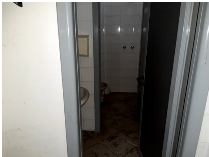
Foto n. 42 – Part. 528 sub 1, 530 e 612 sub 1, graffate - Area dispensa
