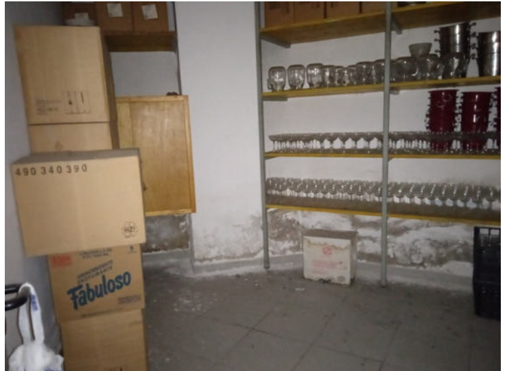
Foto n. 36 – Part. 528 sub 1, 530 e 612 sub 1, graffate - Deposito
