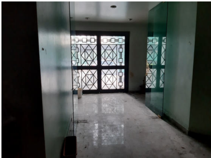
Foto n. 15 – Part. 528 sub 1, 530 e 612 sub 1, graffate - Area ingresso
