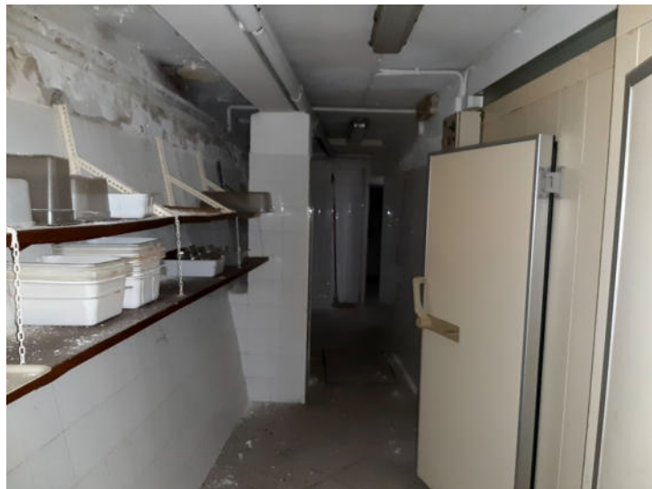
Foto n. 40 – Part. 528 sub 1, 530 e 612 sub 1, graffate - Area dispensa
