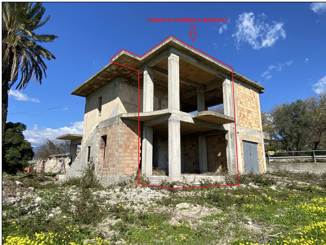
Foto parte abusiva del fabbricato censito al Foglio 23 P.lla 222 Sub. 2
