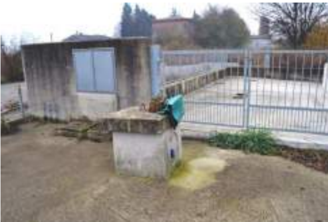
foto 20 - Particolare impianti installati sul m.n. 265
