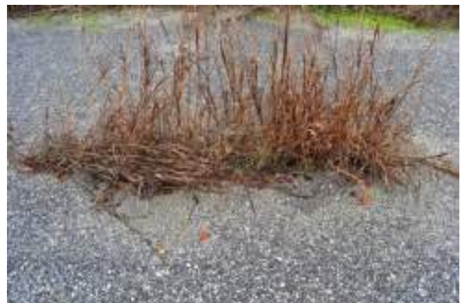
foto 23 - Particolare ammaloramento binder stradale
