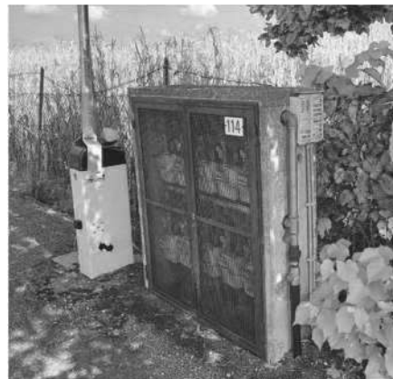
Figura 11: nicchia contatori situata all'inizio dello stradello
