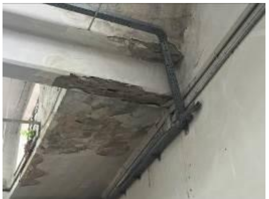
Immagine n. 45 - Dettaglio ammaloramento elementi strutturali
