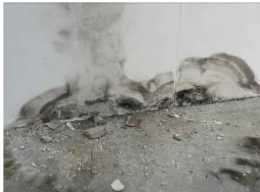
Immagine n. 17 - Dettaglio ammaloramento
