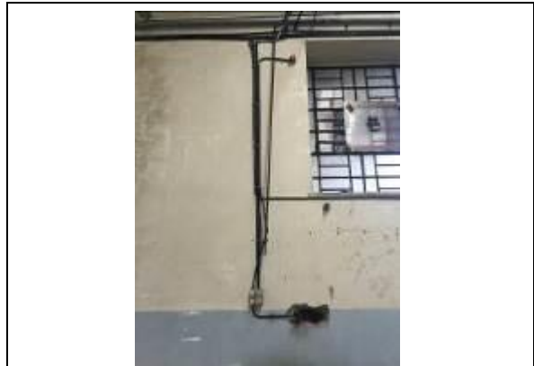
Immagine n. 33 - Dettaglio impianto elettrico
