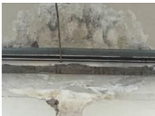
Immagine n. 14 - Stato conservativo trave
