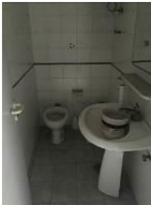
Immagine n. 40 - Bagno uffici
