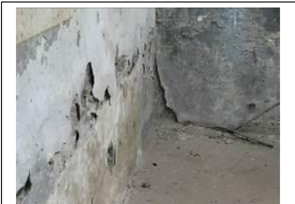
Immagine n. 50 - Dettaglio ammaloramento parete perimetrale
