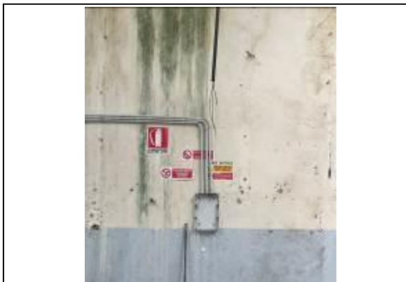
Immagine n.10 - Terminale impianto elettr.
