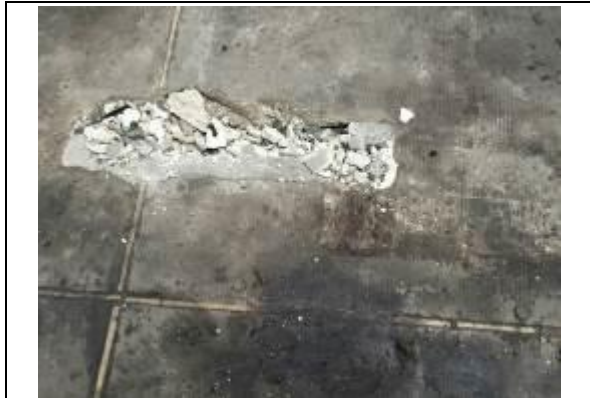
Immagine n.47 -Ammaloramento pavimentazione
