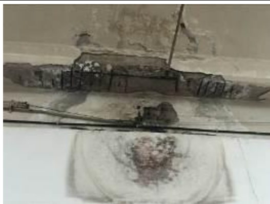
Immagine n. 18 - Dettaglio ammaloramento elementi strutturali
