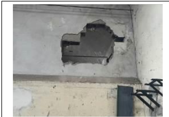
Immagine n. 51 - Foro in parete divisoria ZONA 3
