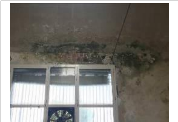
Immagine n. 48 - dettaglio ammaloramento parete perimetrale
