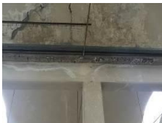
Immagine n. 15 - Corrosione trave e solaio
