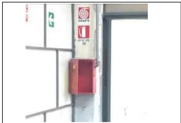
Immagine n. 29 - Terminale impianto antincendio
