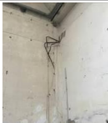
Immagine n. 19 - Dettaglio stato di abbandono
