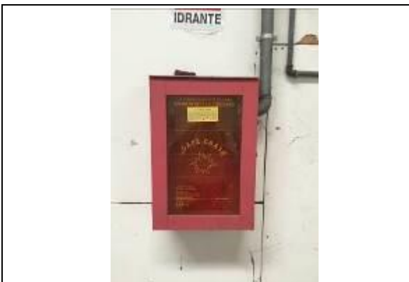
Immagine n. 28 - Terminale impianto antincendio
