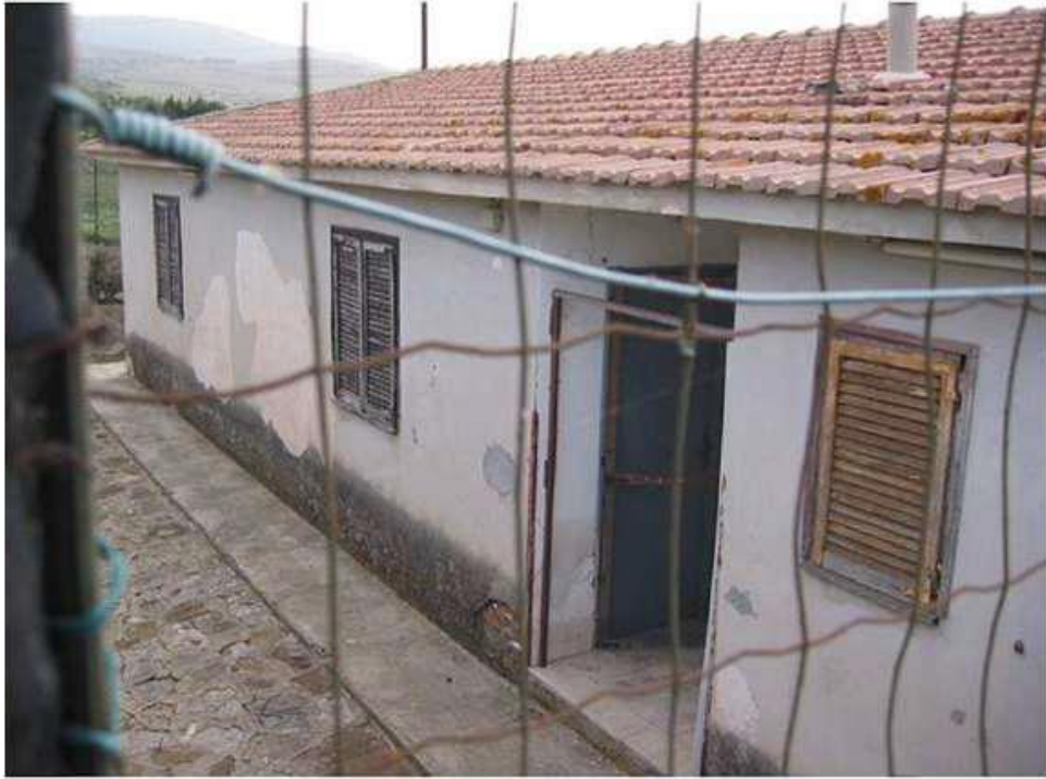
DETTAGLIO UMIDITA' DI RISALITA MURATURE PROSPETTO EST
