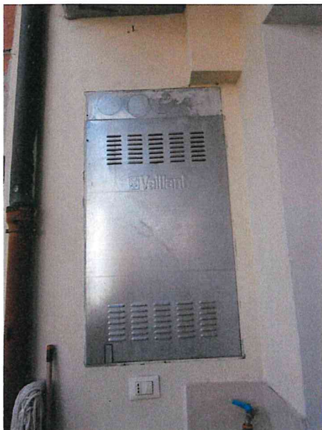
Foto 03bis particolare caldaia
