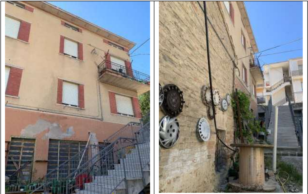
FOTO 3 – SCALE ESTERNE ACCESSO AL PIANO SEMINTERRATO ED ALTRE PROPRIETA' CONFINANTI
