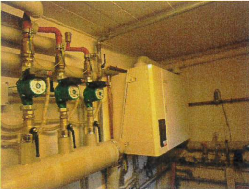
Lotto 5 -Villa in Comune di Tresivio centrale termica
