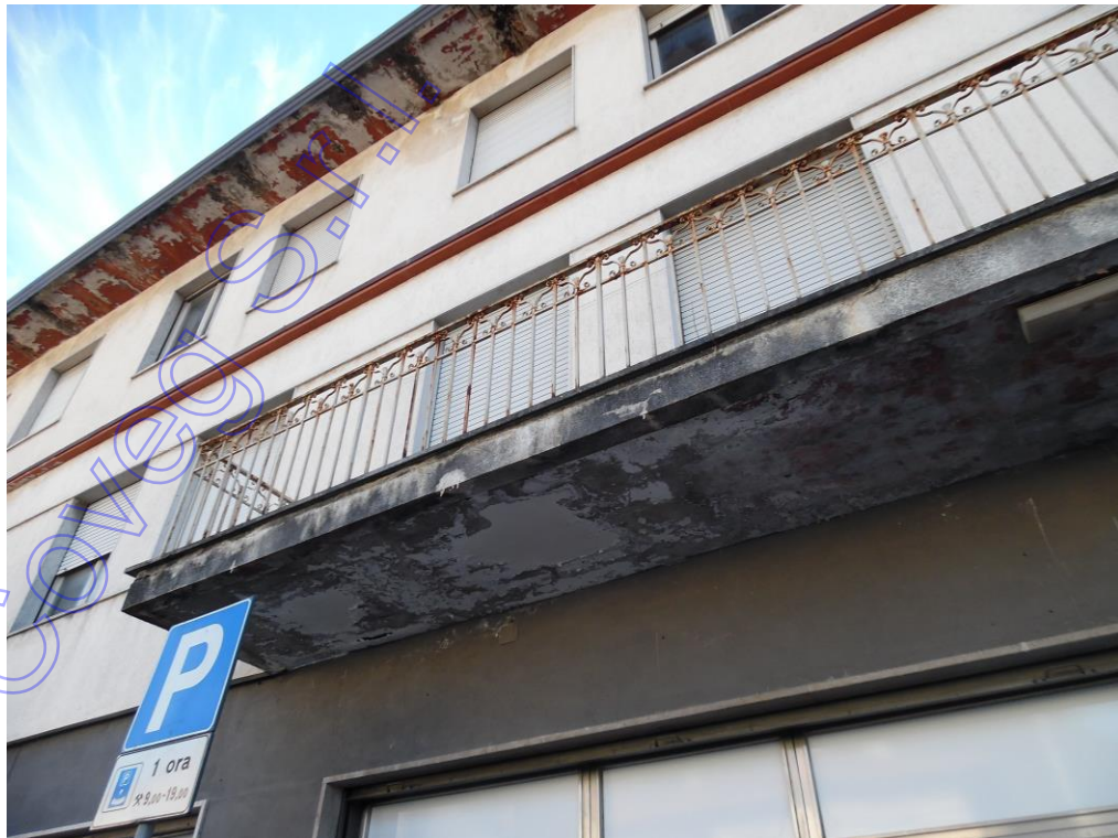
Particolare infiltrazioni/muffe/distacco intonaco su balcone prospetto N/E su Via Paluzza
