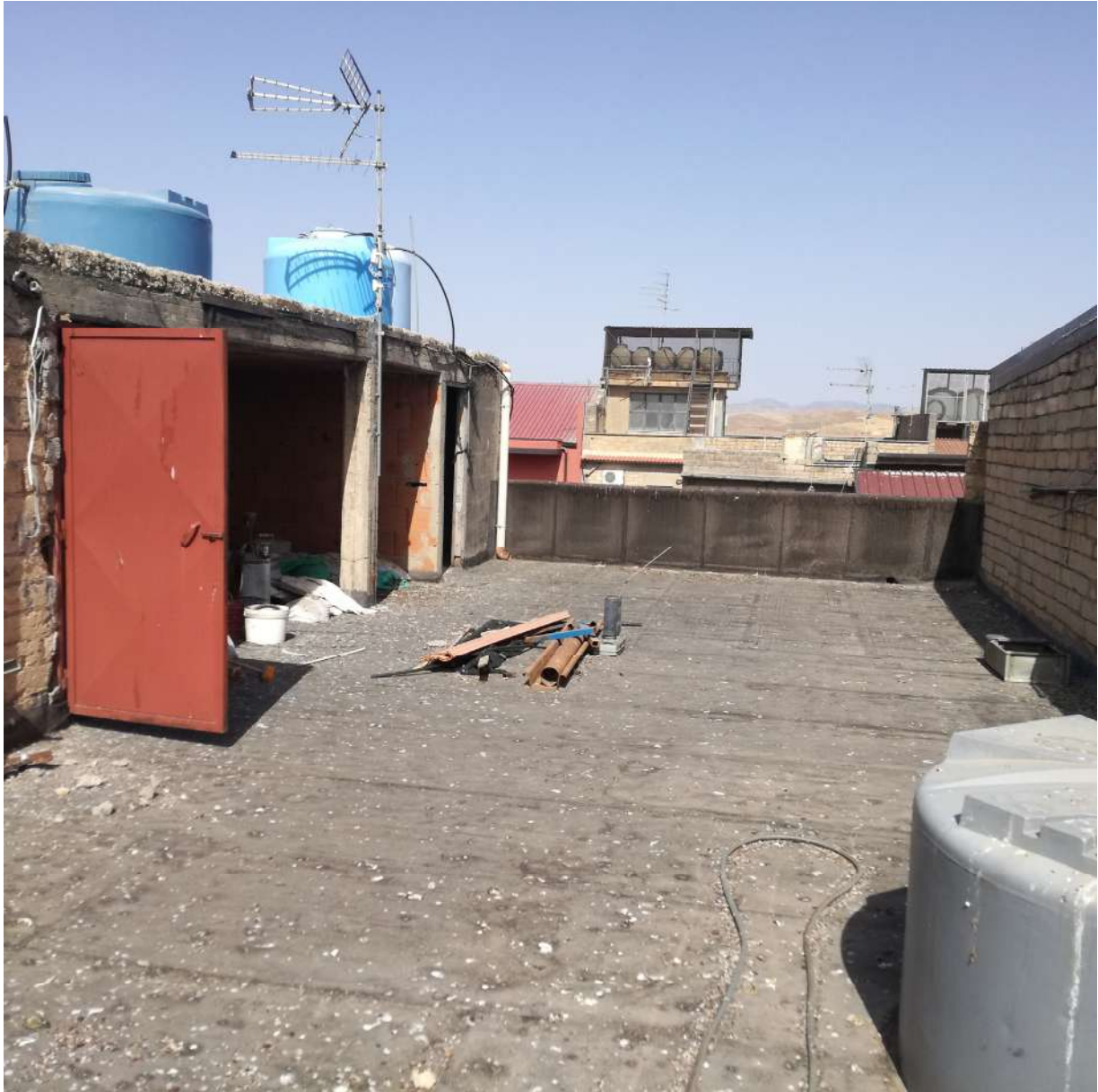
Foto n. 16 - Vista della copertura a terrazzo comune del fabbricato in cui è posto l'immobile pignorato
