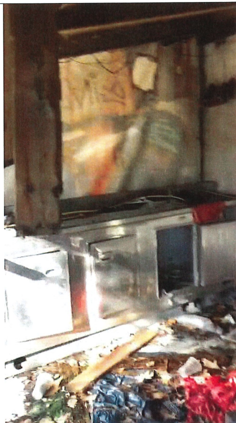
Lo stato vandalizzato dell'immobile
