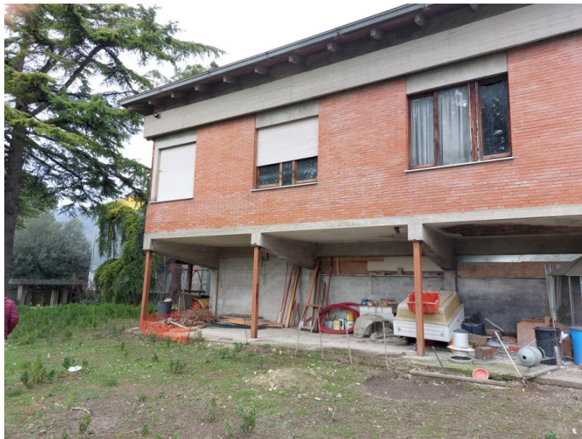
Foto n.66: Particolare del fabbricato residenziale (BENE L). Notare le finestre con infissi in legno e tapparelle in PVC.
