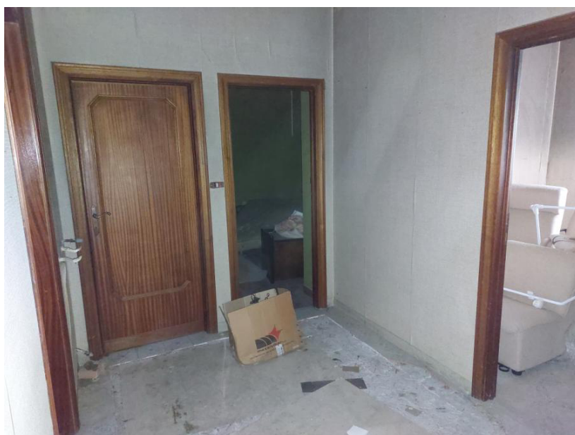
Foto n.78: Particolare del corridoio di smistamento al piano primo (BENE L). Sono visibili, sulla destra dell'immagine, la studio e centralmente le porte in legno tamburato che delimitano le aperture alle due camere. Notare il pavimento danneggiato e le pareti rivestite con carta da parati.
