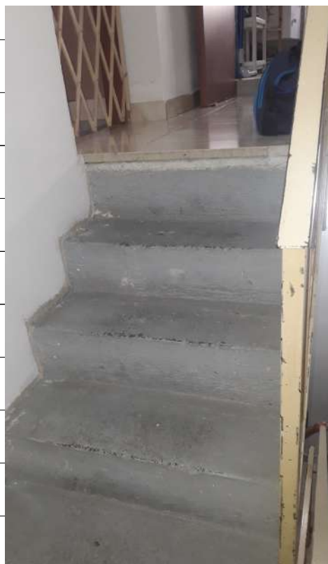
Foto n.20: immagine interna del vano scala di collegamento tra i piani primo e secondo.
