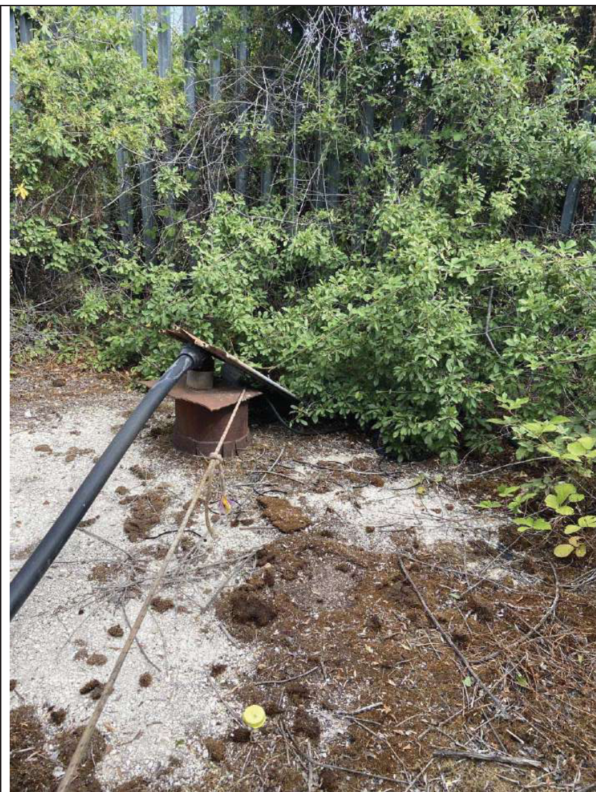
Foto 14) – Vista dettaglio pompa sollevamento su particella confinante priva di recinzione
