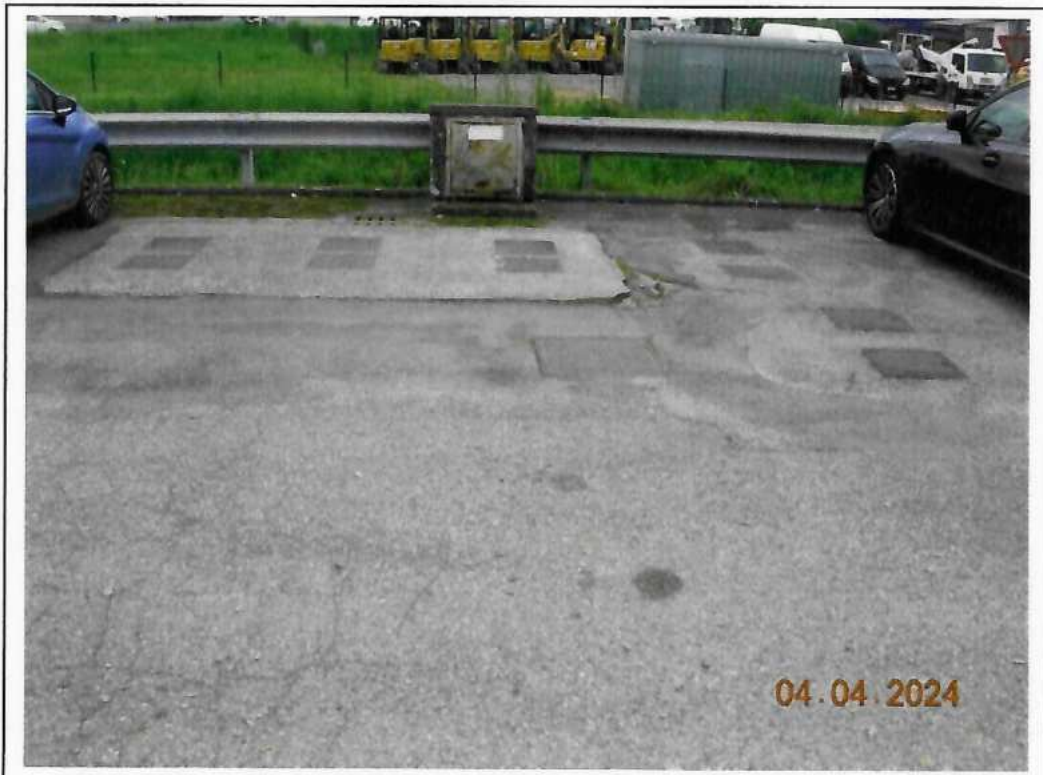
Tricamerale per lo smaltimento acque reflue
