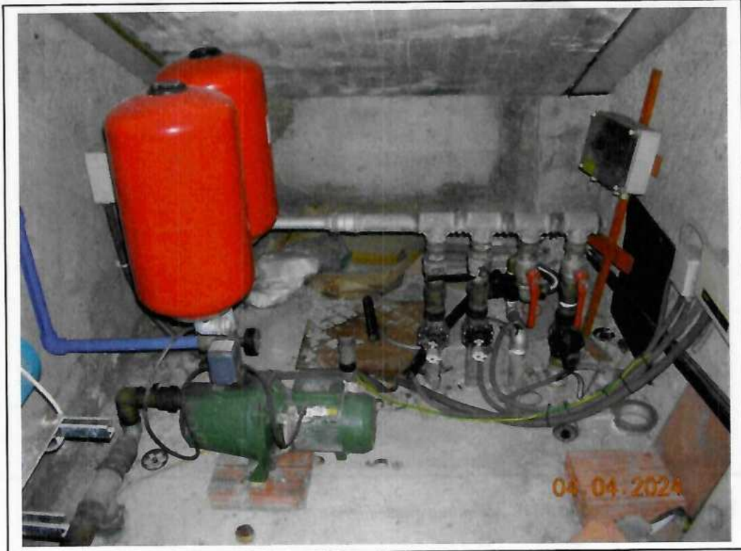
Pompa per l'emungimento della falda acquifera
