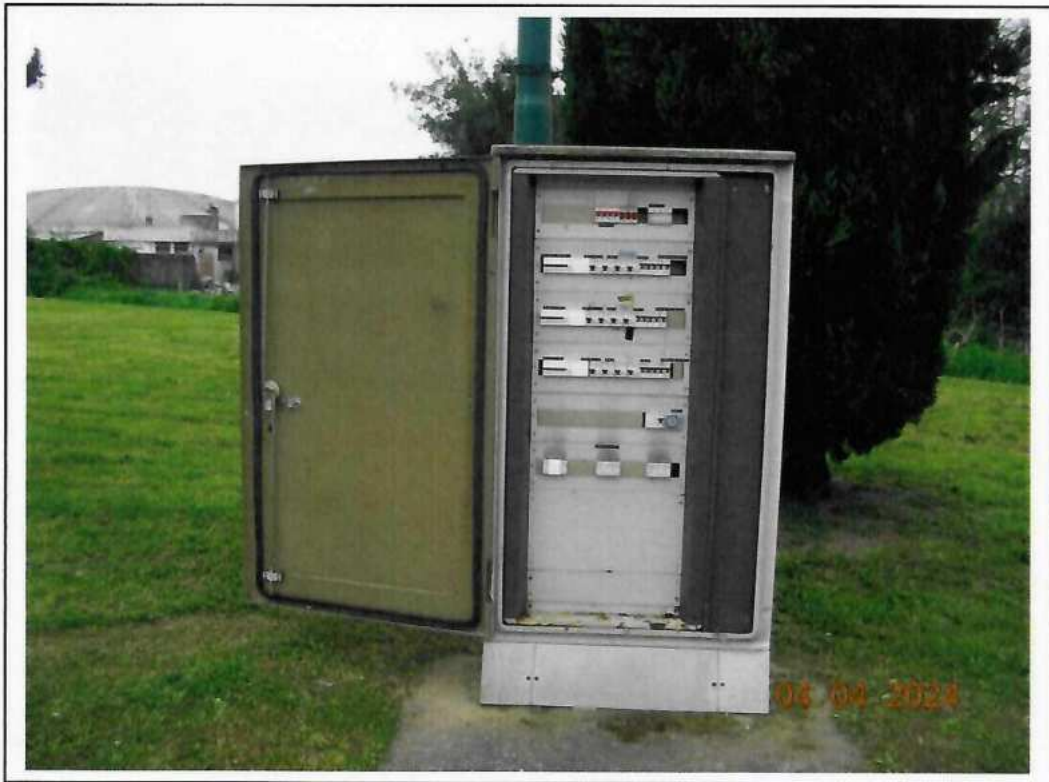
Quadro generale ( Condominio quadrifoglio )
