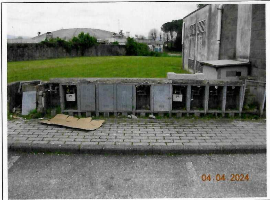
Vano Contatori Gas (Condominio quadrifoglio)
