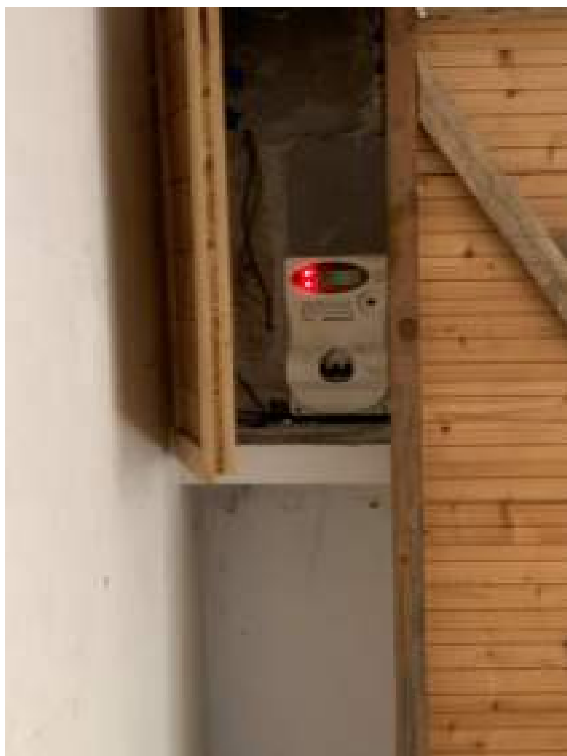
Foto 3.B: esempio di impiantistica esistente o in fa se di realizzazione
