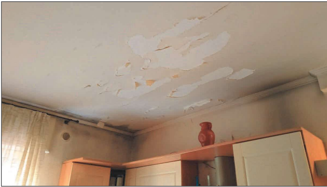
Foto 13 – Ammaloramento intradosso angolo cottura.
