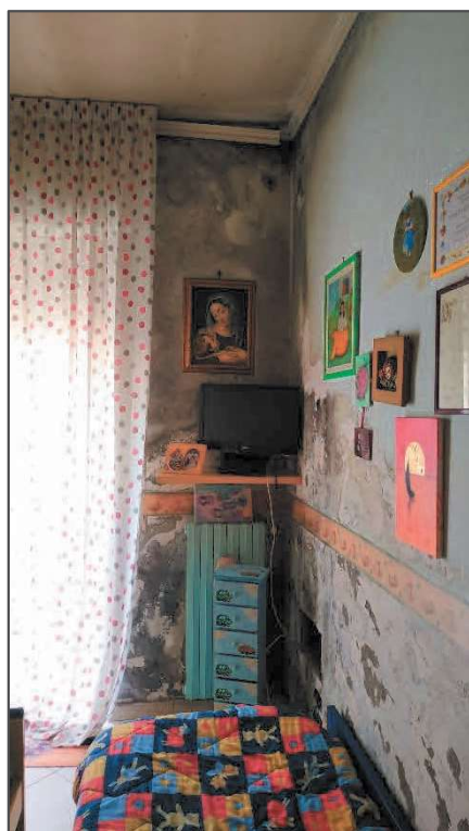
Foto 11 – Ammaloramento infiltrazioni cameretta.
