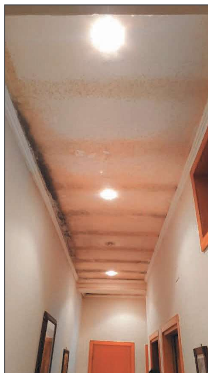
Foto 12 – Ammaloramento intradosso corridoio.
