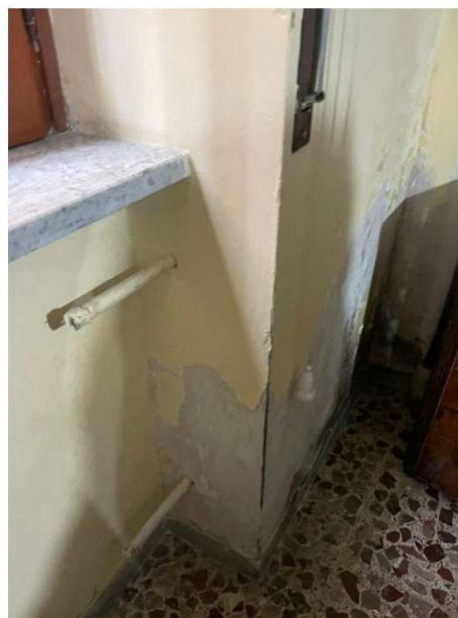
Tracce di umidità di risalita
