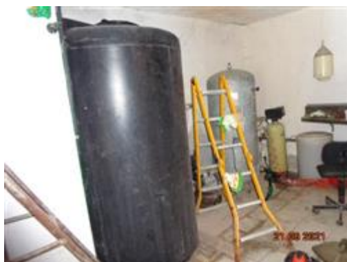
CISTERNA DI ACCUMULO ACQUA PROVENIENTE DA POZZO UBICATO IN ALTRA PROPRIETA' ESTRANEA AL PRESENTE PIGNORAMENTO
