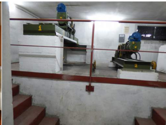
sala macchine ascensori
