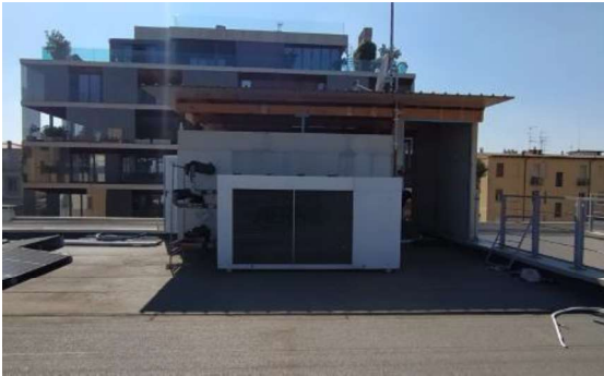
Locale impianti in copertura
