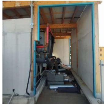
Interno locale impianti in copertura
