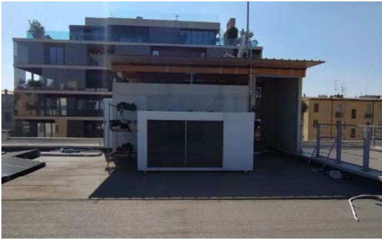
Locale impianti in copertura
