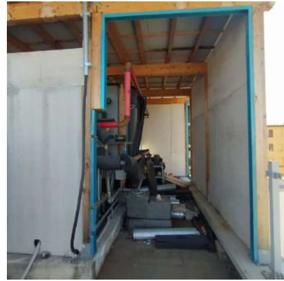
Interno locale impianti in copertura
