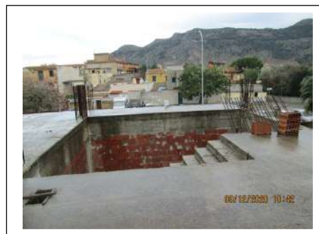
Foto 80. Edificio in corso di costruzione. Estradosso del solaio del piano terra e corpo scala
