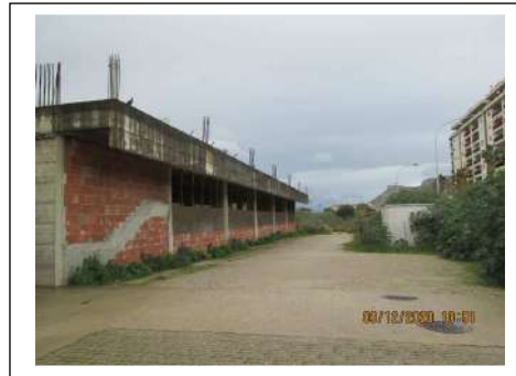
Foto 7. Fabbricato in corso di costruzione oggetto di pignoramento identificato al sub. 14. Veduta del fronte est
