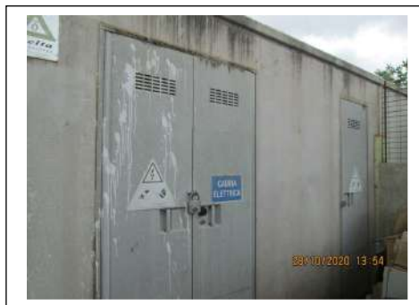
Foto 19. Cabina elettrica identificata al sub. 9 della p.lla 1050
