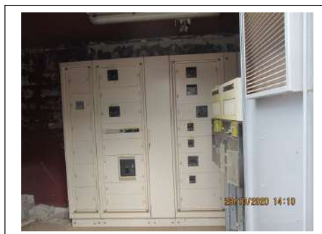
Foto 25. Cabina elettrica identificata al sub. 10 della p.lla 1050. Interno
