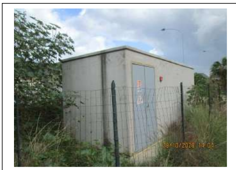
Foto 18. Cabina elettrica identificata al sub. 9 della p.lla 1050
