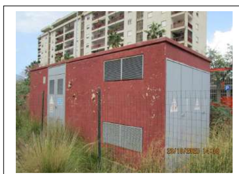
Foto 23. Cabina elettrica identificata al sub. 10 della p.lla 1050
