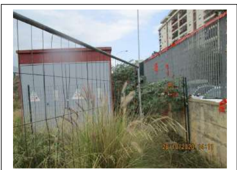
Foto 24. Cabina elettrica identificata al sub. 10 della p.lla 1050
