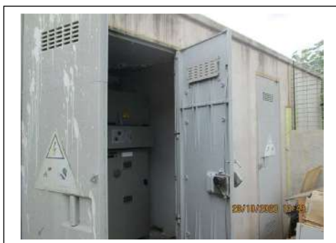
Foto 20. Cabina elettrica identificata al sub. 9 della p.lla 1050
