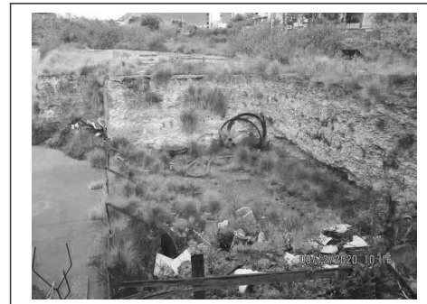
Foto 13. Scavo di sbancamento con vegetazione spontanea e rifiuti di vario genere
