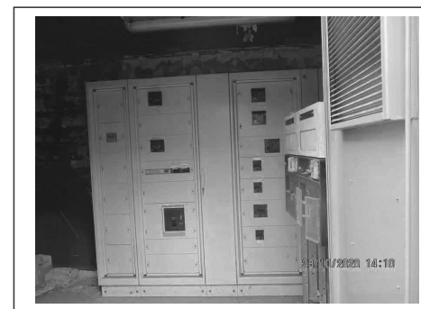
Foto 25. Cabina elettrica identificata al sub. 10 della p.la 1050. Interno
