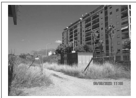
Foto 212 Cabina elettrica identificata al sub. 10 della p.la 1050
