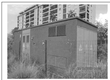
Foto 23. Cabina elettrica identificata al sub. 10 della p.la 1050
