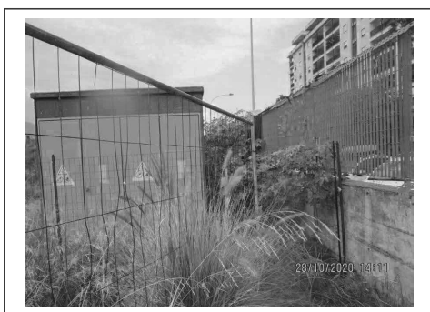
Foto 24. Cabina elettrica identificata al sub. 10 della p.la 1050
