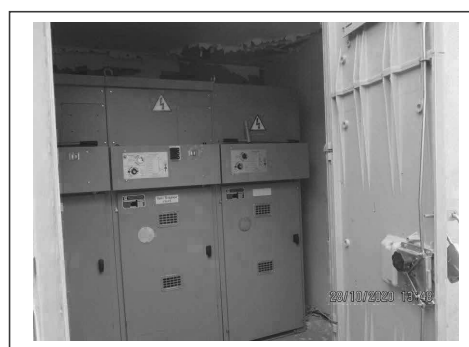
Foto 21. Cabina elettrica identificata al sub. 9 della p.lla 1050. Interno
