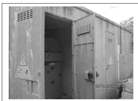
Foto 20. Cabina elettrica identificata al sub. 9 della p.lla 1050
