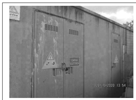
Foto 19. Cabina elettrica identificata al sub. 9 della p.lla 1050
