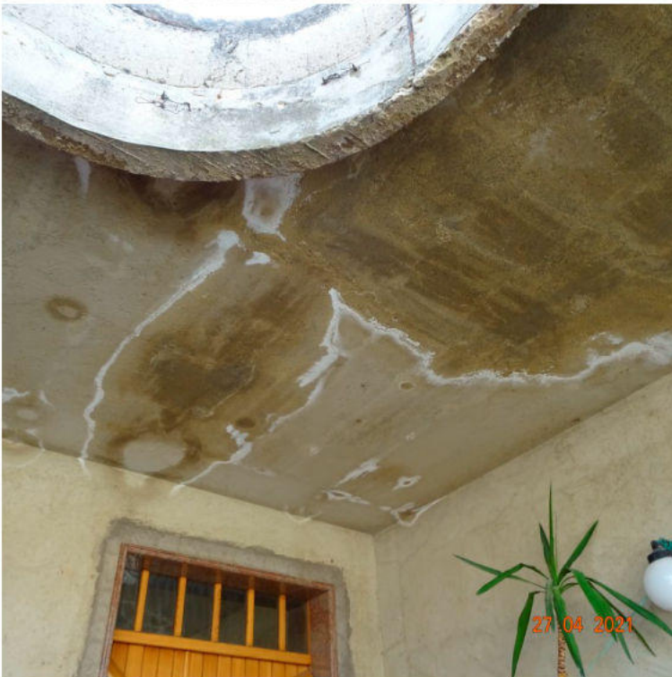
FOTO N. 4 INGRESSO CON MACCHIE DIFFUSE DI INFILTRAZIONE DAL TETTO
