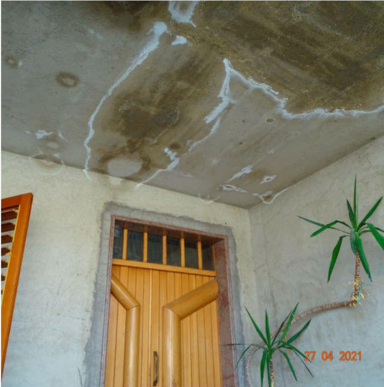
FOTO N. 3 INGRESSO CON MACCHIE DIFFUSE DI INFILTRAZIONE DAL TETTO
