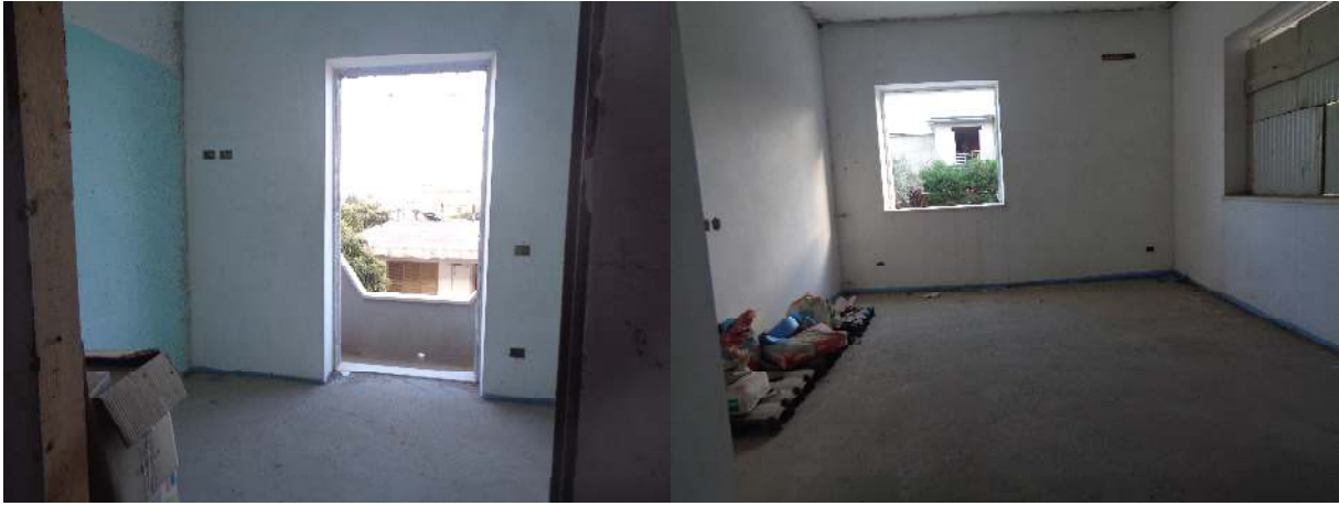
Fig.18 - Foto – Siderno. (RC) Vista interna – piano terra -primo Contrada Grappidaro foglio 16 part. 988-sub 6
