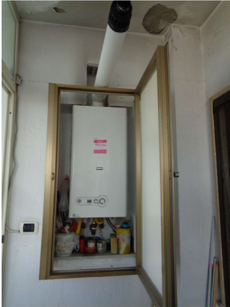
Foto n. 36: • Caldaia murale per riscaldamento e acqua calda.
