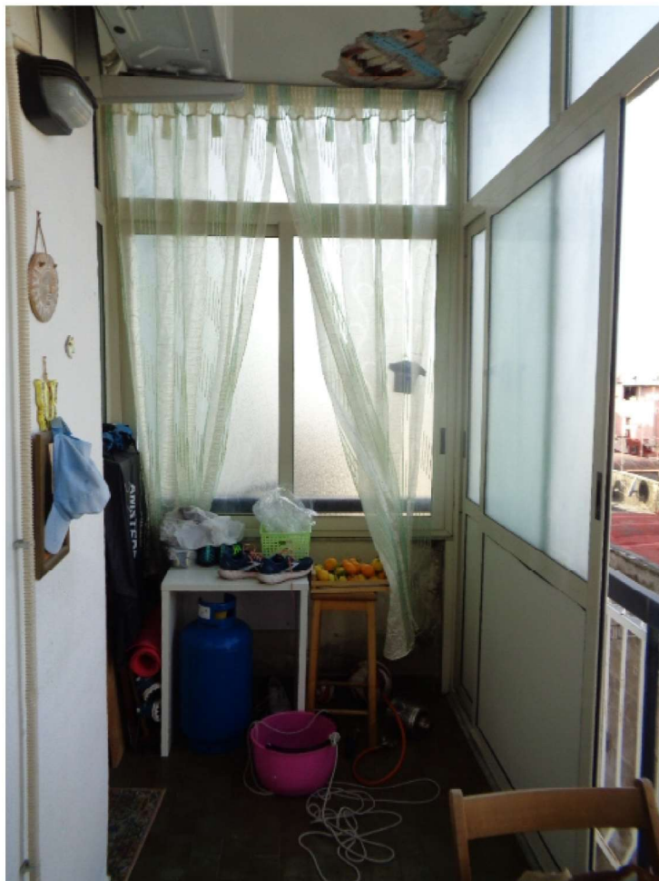
Foto n. 23: • Veranda abusiva all'esterno dell'angolo cottura.
