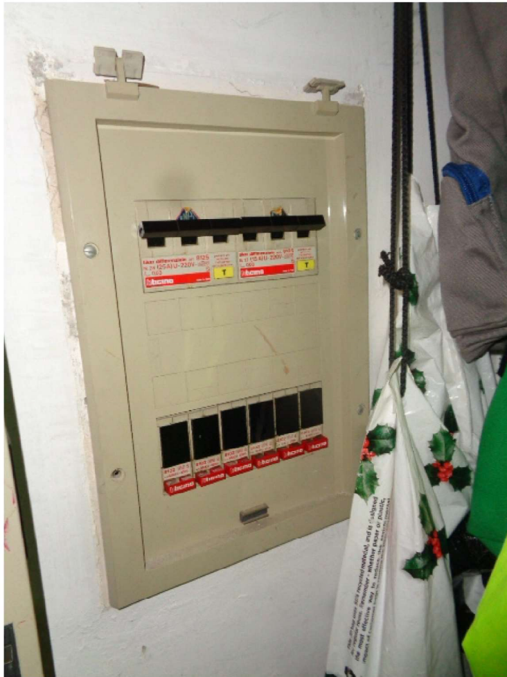
Foto n. 37: • Quadro elettrico obsoleto.
