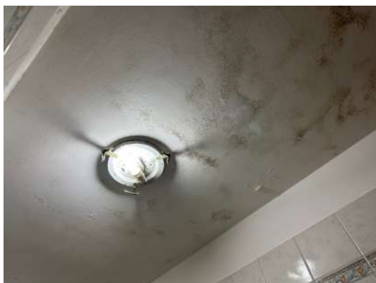
Dettaglio soffitto bagno.
