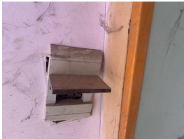
Foto interna – dettaglio impianto elettrico
