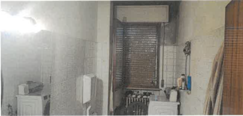
Foto n° 16 – bagno appartamento sub 11
