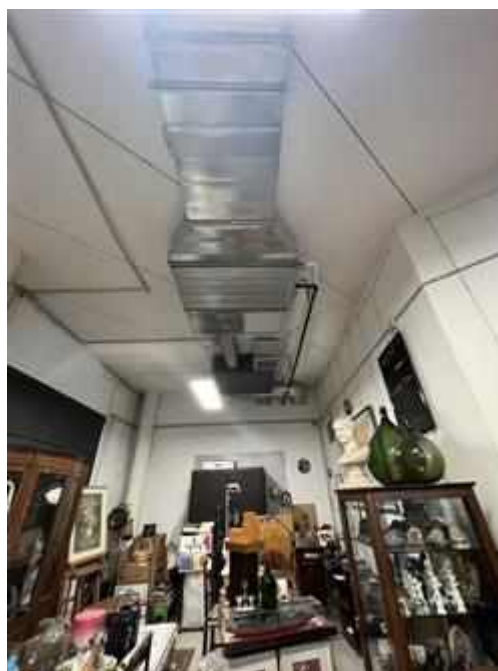
vista degli impianti a soffitto
