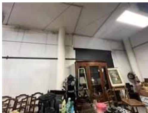
vista di alcune macchie di infiltrazioni presenti sulla parete ovest
