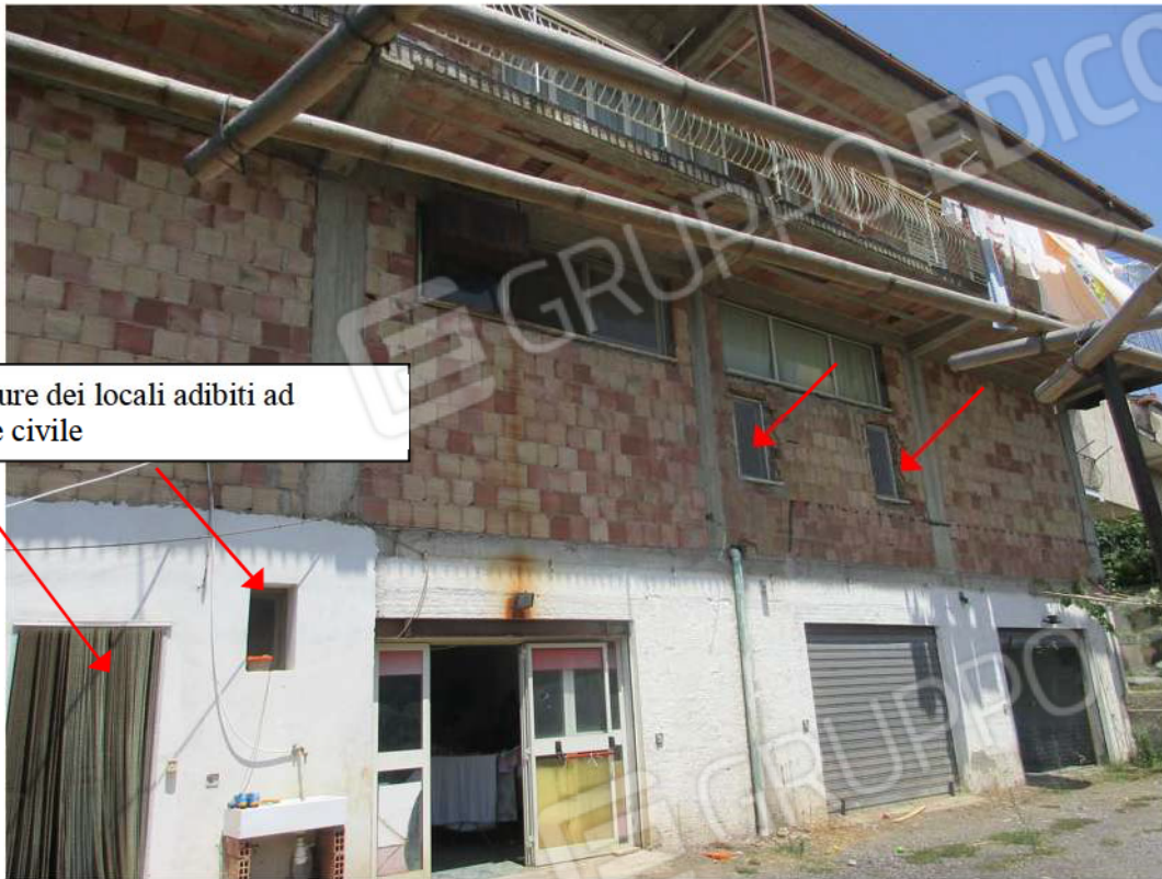
Foto 5 – Particolare prospetto est fabbricato: in evidenza le aperture abusive
