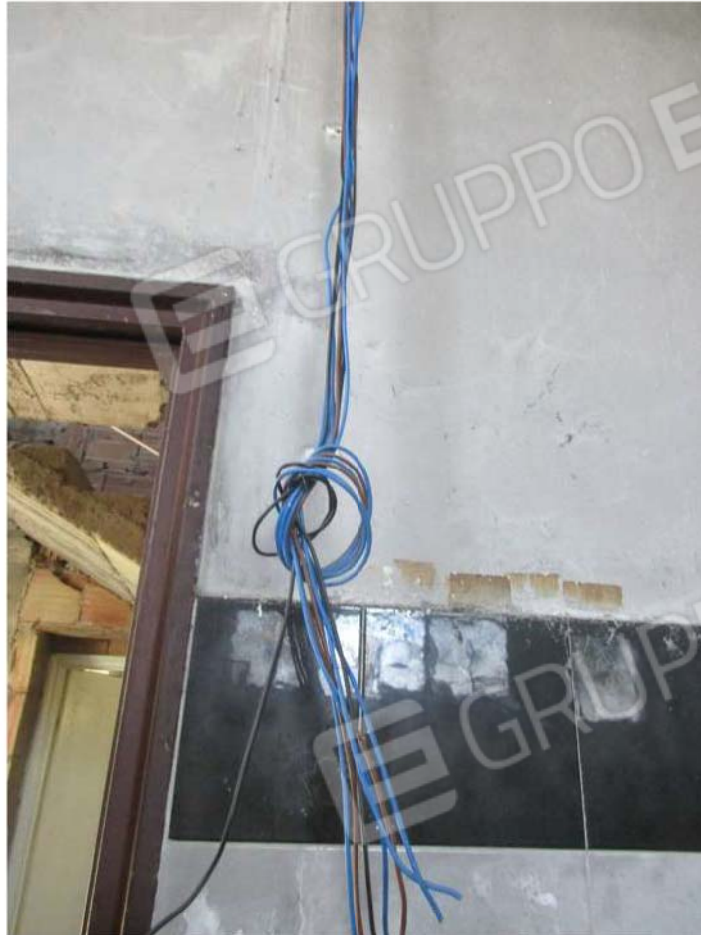
Foto 31: Altra immagine descrittiva dell'impianto elettrico
