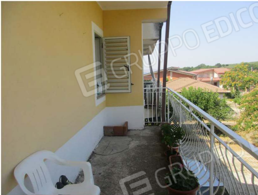
Foto 53: Il balcone sul prospetto ovest: in evidenza l'assenza della pavimentazione
