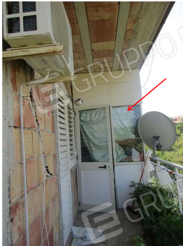
Foto 77: Balcone sul fronte sud del fabbricato: in evidenza il locale realizzato senza titolo edilizio
