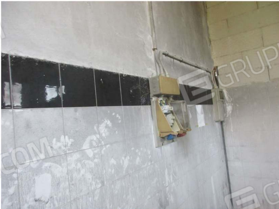
Foto 30: Immagine descrittiva dello stato dell'impiantistica elettrica
