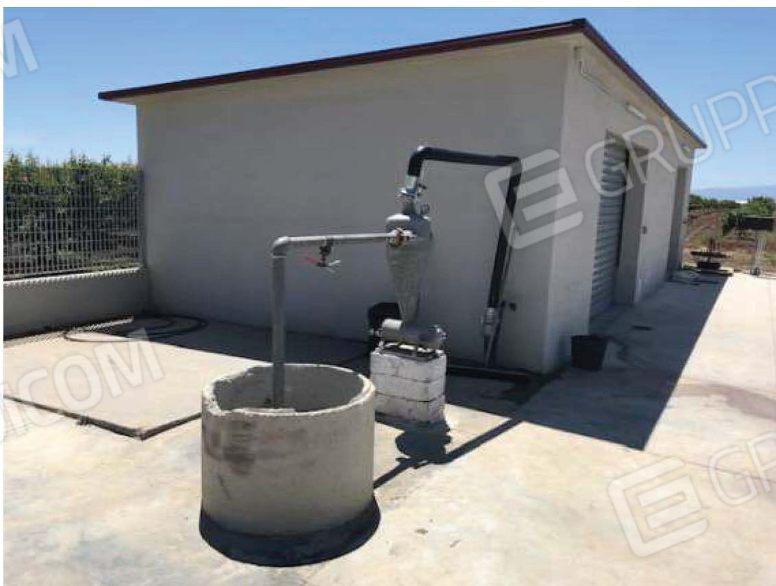
Foto 10 – Sistema di emungimento dell'acqua potabile dal pozzo
