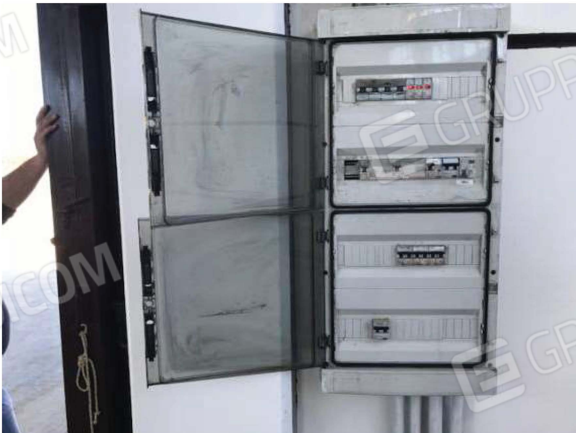
Foto 10 – Dettaglio del quadro elettrico del capannone
