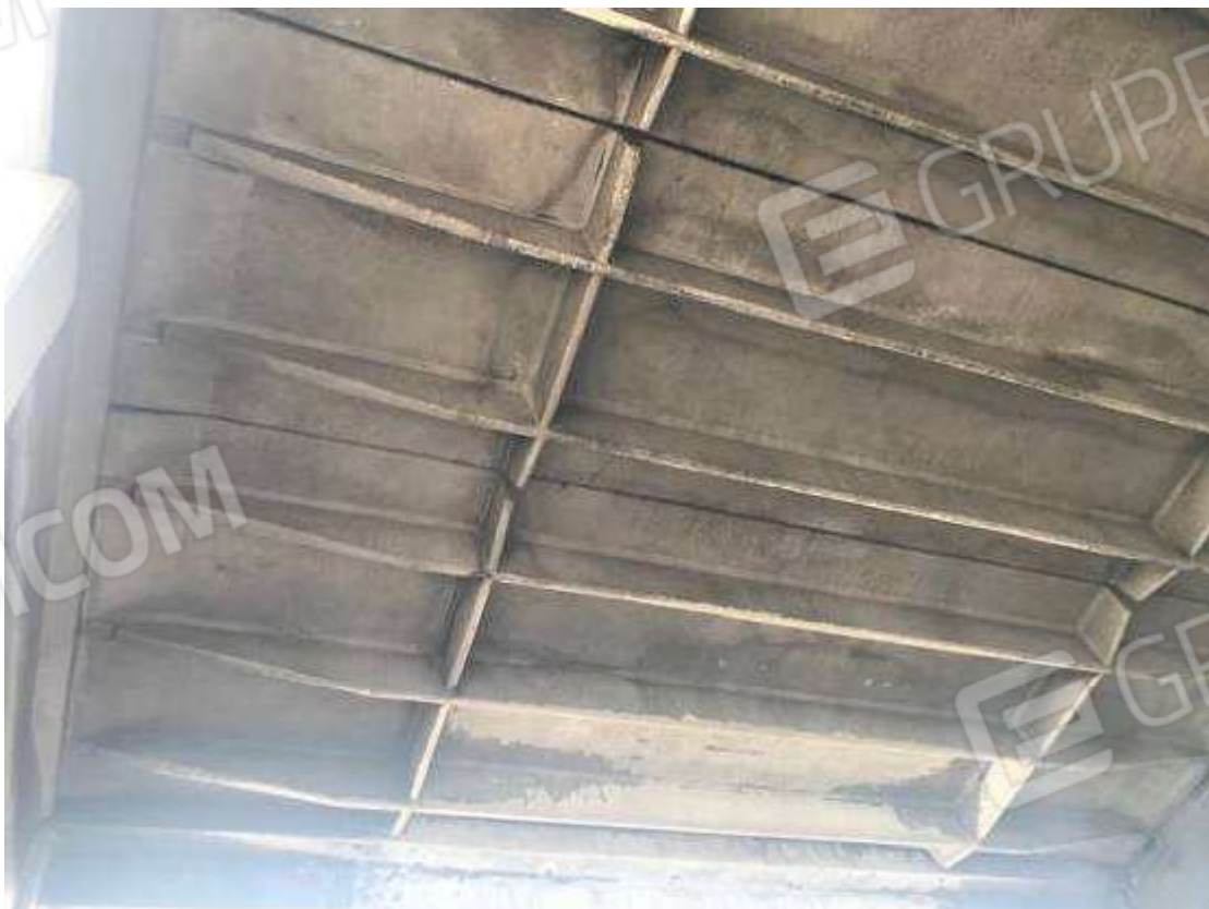
Foto 06 – Interni del capannone – Intradosso della copertura (prima campata, entrando dall'ingresso principale - zona di sinistra). La soletta e le nervature degli elementi prefabbricati sono state lievemente danneggiate dall'incendio, ma non presentano segni di instabilità.
