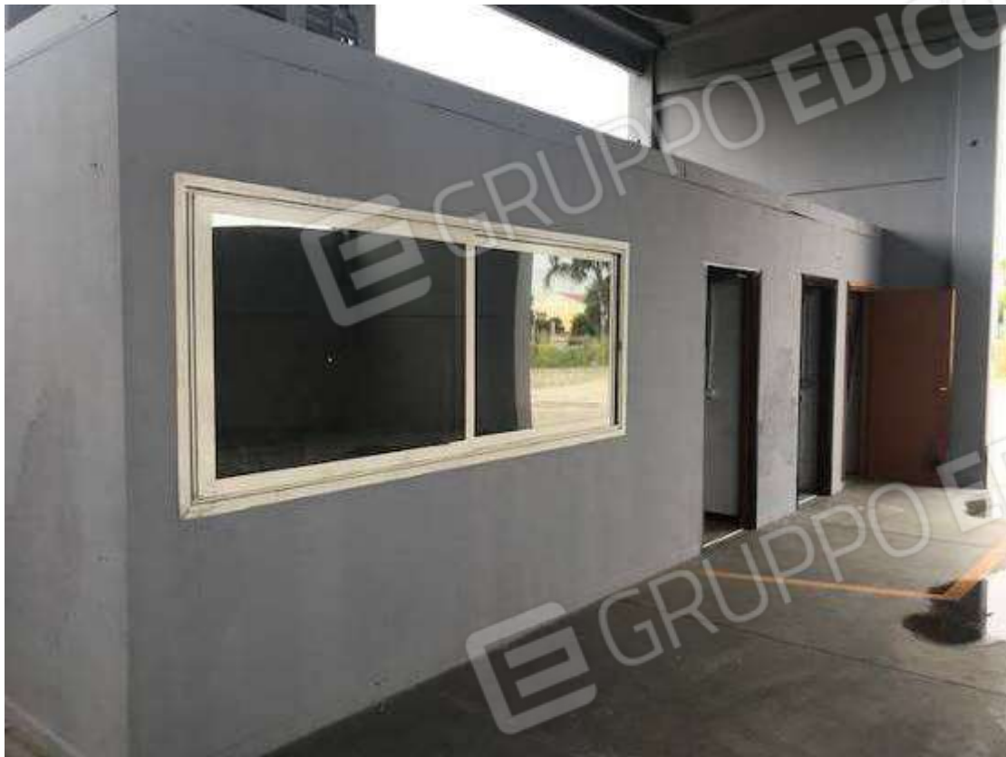
Foto 13 – Interni del capannone – Zona uffici e bagni. Si evince la totale assenza degli impianti preesistenti.
