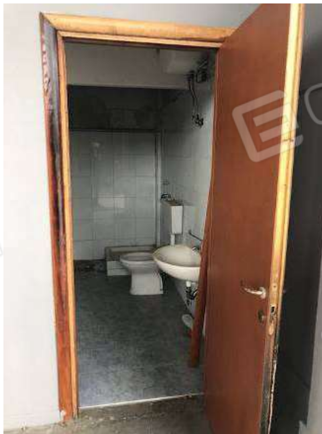
Foto 16 – Interni del capannone – Primo bagno, entrando dall'ingresso principale. La porta risulta parzialmente divelta e danneggiata fuoco.
