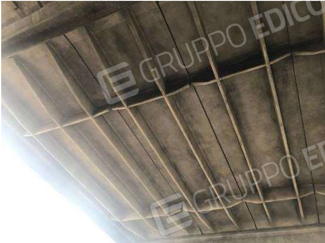
Foto 09 – Interni del capannone – Intradosso della copertura (seconda campata, entrando dall'ingresso principale - zona di sinistra) La soletta e le nervature degli elementi prefabbricati non sono state danneggiate dall'incendio.
