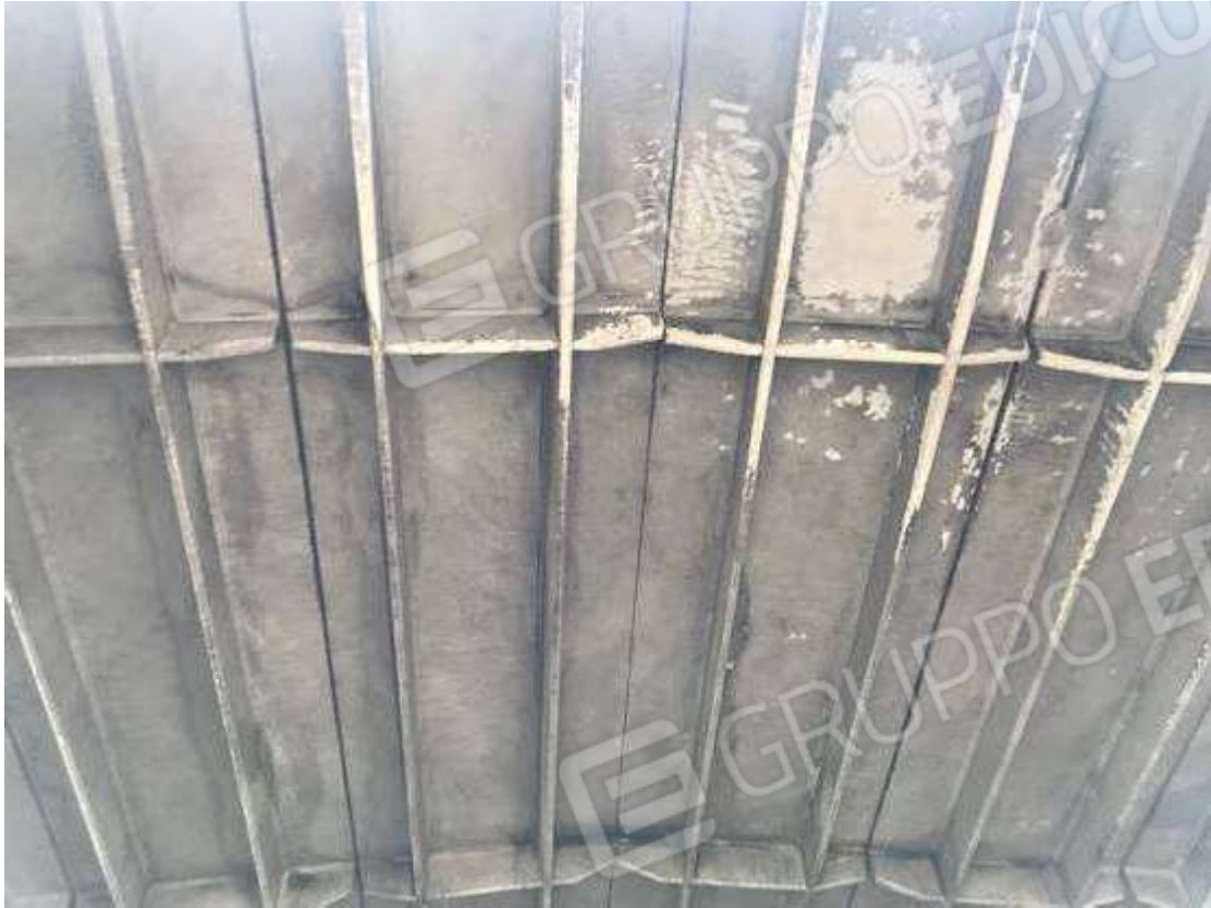
Foto 07 – Interni del capannone – Intradosso della copertura (prima campata, entrando dall'ingresso principale - zona centrale). La soletta e le nervature degli elementi prefabbricati sono state lievemente danneggiate dall'incendio, ma non presentano segni di instabilità.
