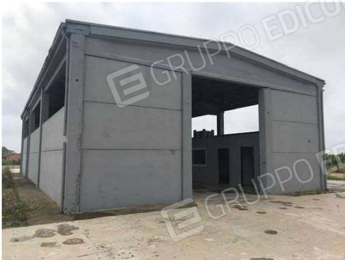
Foto 01 – Esterni del capannone – Vista della testata destra (ingresso principale) Il portone d'ingresso non esiste più.
