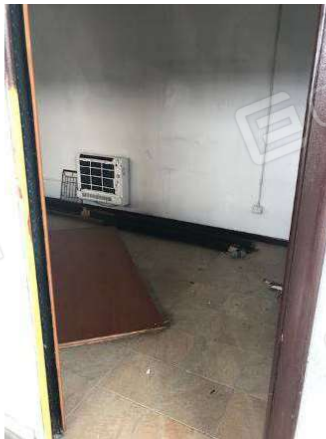
Foto 14 – Interni del capannone – Ufficio La porta risulta parzialmente danneggiata dal fuoco.
