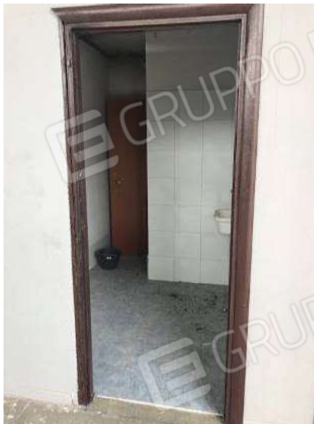
Foto 15 – Interni del capannone – Bagno centrale. Le mostre ed il telaio fisso risultano parzialmente danneggiati dal fuoco.
