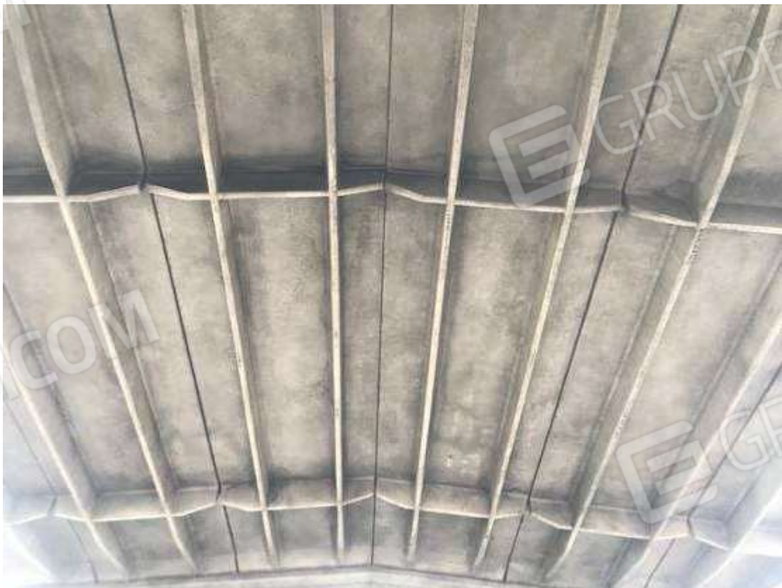
Foto 08 – Interni del capannone – Intradosso della copertura (seconda campata, entrando dall'ingresso principale - zona centrale) La soletta e le nervature degli elementi prefabbricati non sono state danneggiate dall'incendio.
