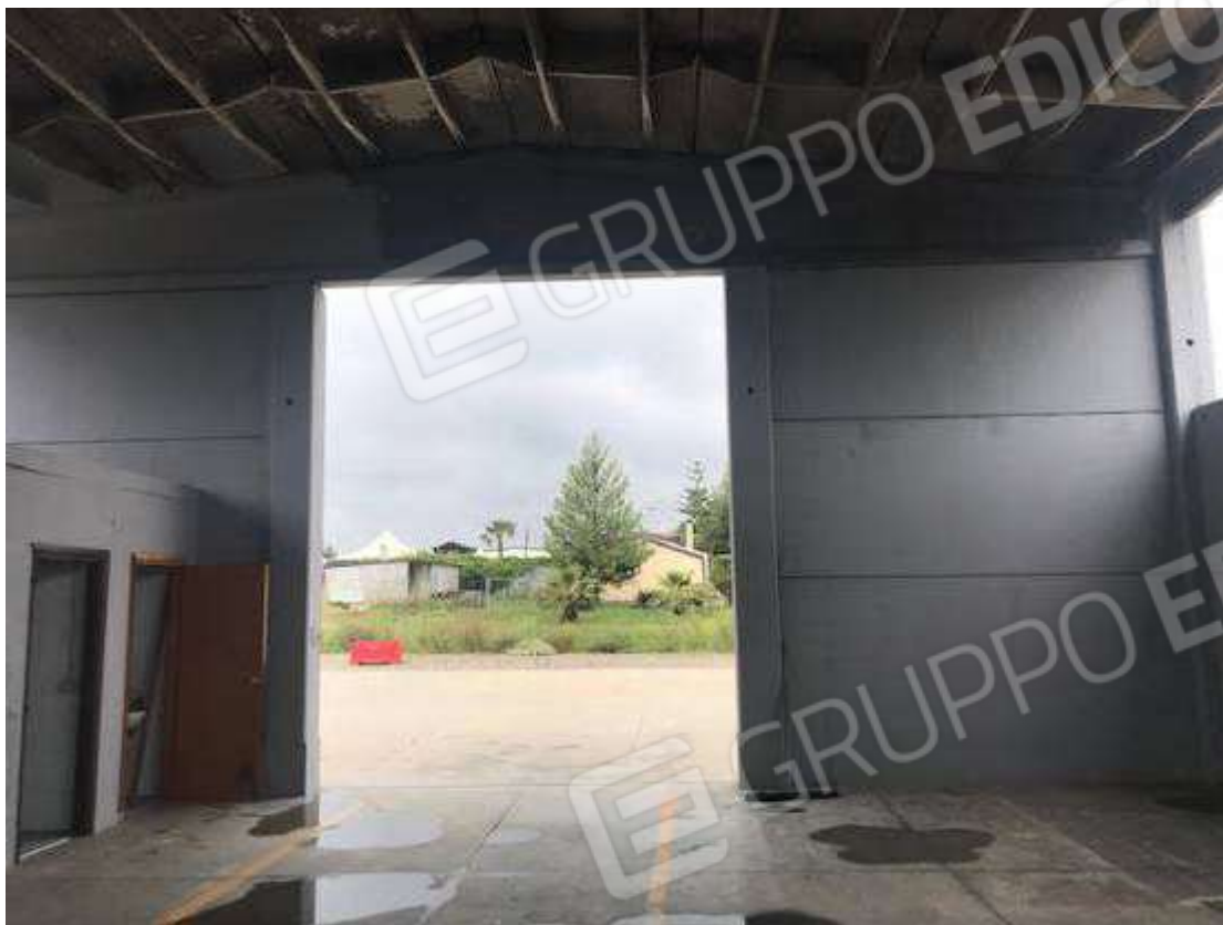
Foto 17 – Interni del capannone – Zona prossima all’ingresso principale anteriore. Si evince la totale assenza degli impianti e del portone preesistenti.
