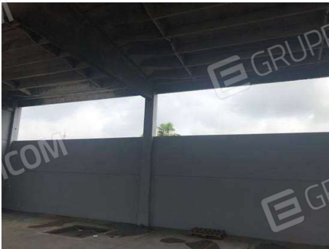
Foto 18 – Interni del capannone – Zona di sinistra (entrando dall’ingresso principale anteriore). Si evince la totale assenza degli impianti e delle finestre “a nastro” preesistenti.
