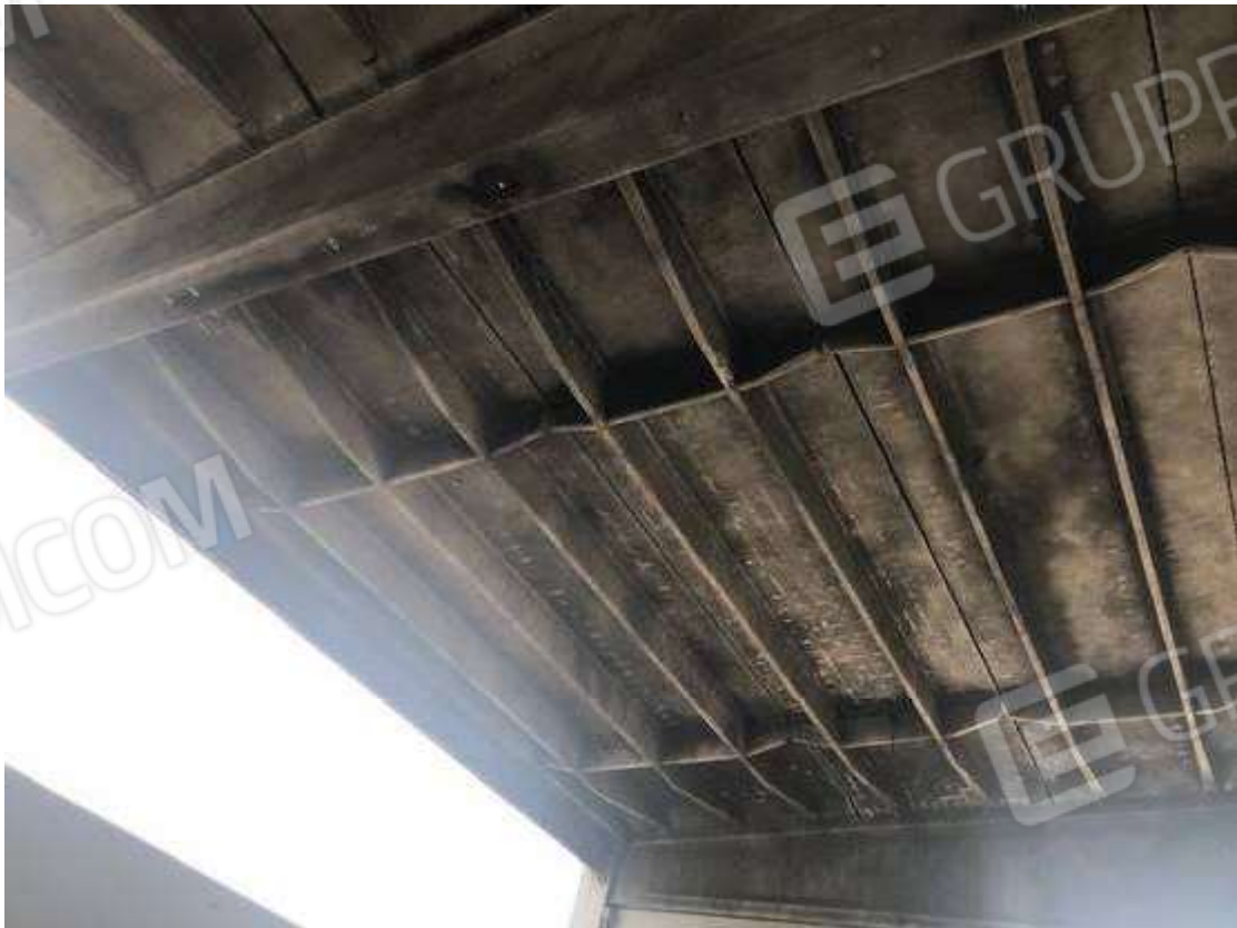
Foto 12 – Interni del capannone – Intradosso della copertura (ultima campata, entrando dall'ingresso principale - zona di sinistra) La soletta e le nervature degli elementi prefabbricati non sono state danneggiate dall'incendio.
